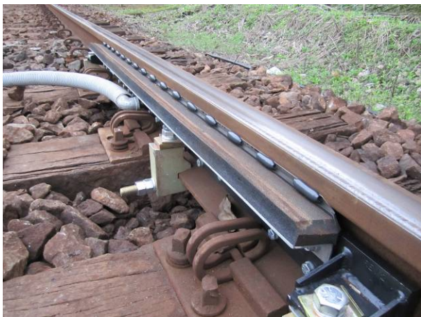
Figura 04 – Barra distribuidora de lubrificante.
