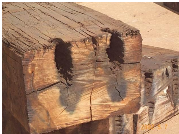
Fig. 4 D. Eucalipto, apodrecimento apenas no interior dos furos.
