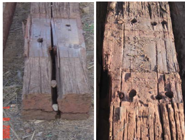
Fig.1 Fendilhamento e furação alargada.
