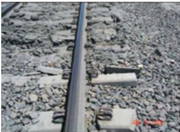
Fig. 14 DC destruídos em local de excesso de (k) .
