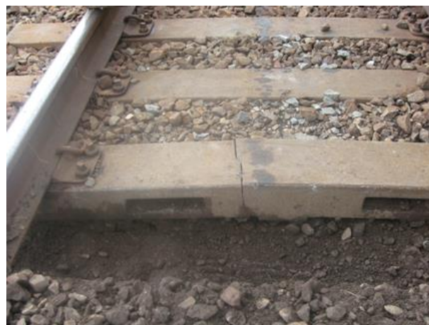
Fig. 8 DPR de bitola larga c/ fratura “center bound” assentado em lastro contaminado e insuficiente.
