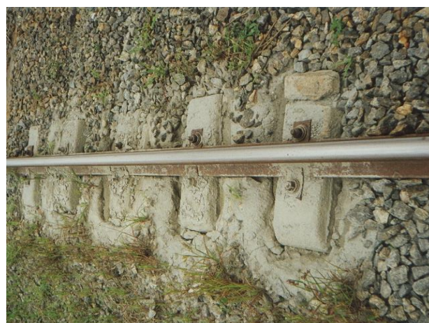
Fig. 24 Linha SP da MRS e DC bibloco, c/ bolsão, lastro com vegetação (contaminado c/finos).
