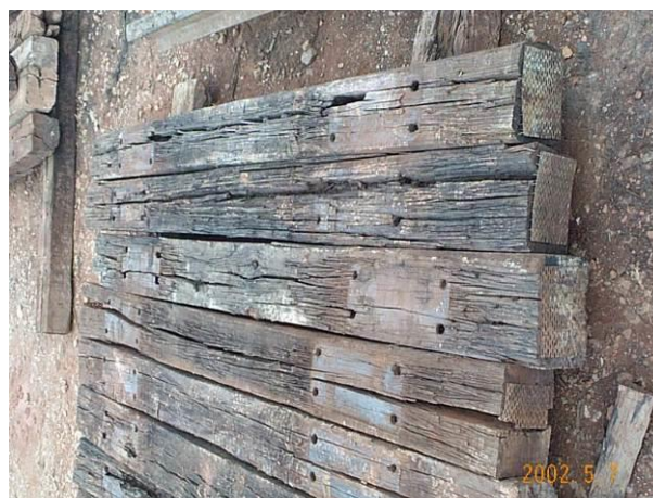
Fig. 3 D. Eucalipto na MRS retirados devido ao apodrecimento nos furos e fendilhamento.
