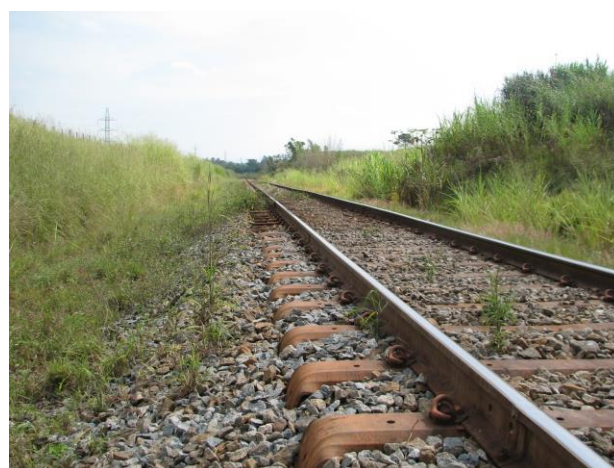
Fig. 25 Linha SP da MRS e DA, isenta de defeitos, lastro com vegetação e ainda contaminado.
