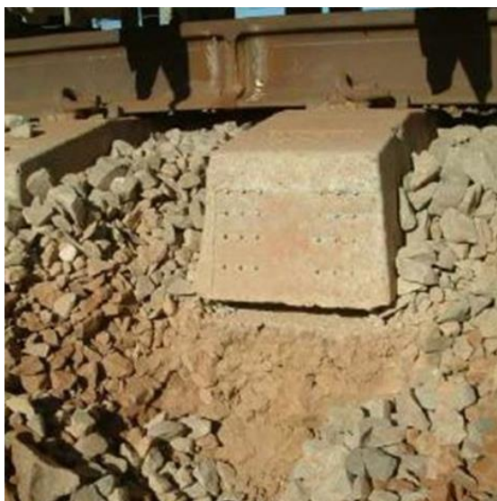
Fig. 16 Anomalia na solda e lastro pulverizado.
